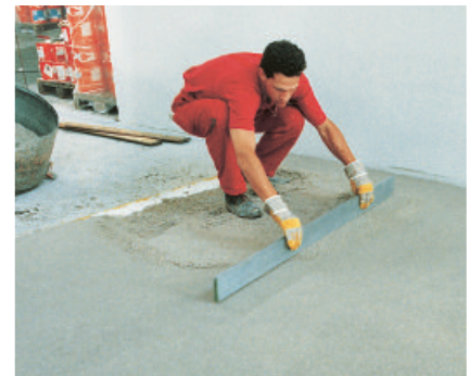
Het plaatsen van een zeer slijtvaste, chemicaliënbestendige industriedekvloer met PCI Bauharz mortel.
