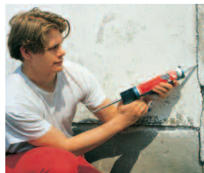
Scheuren in pleister kunnen met PCI Adaptol elastisch worden gevuld.
