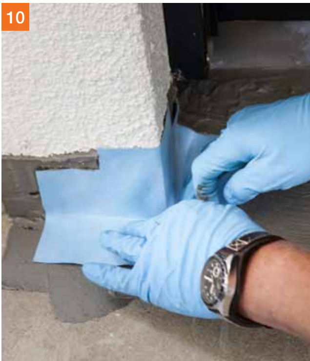
10 Detail: wandaansluiting. PCI Seccoral® 2K Rapid aanbrengen en een hoekafdichting PCI Pectape 90°A (buitenhoek) plaatsen
