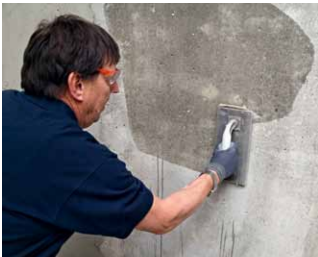
Door het beton vooraf goed nat te maken neemt het zuigvermogen af en voorkomt u dat te snel water wordt onttrokken aan de afdichtingscoating.
