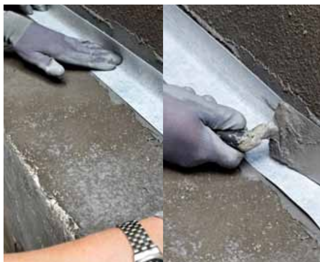
... dan wordt de kimband PCI Pectape® Objekt in de verse afdichtingscoating gelegd en voorzichtig aangedrukt. De randen van de kimband worden vervolgens met PCI Seccoral® 2K Rapid afgewerkt.
