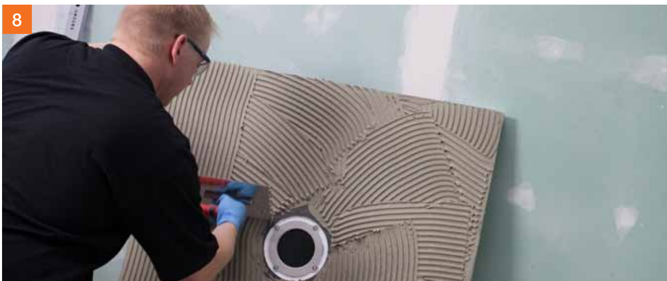
8 Breng eerst een dunne contactlaag lijm aan op de onderplaat en op de rug van de PCI Pecibord® en kam vervolgens de lijm op met een lijkam.
