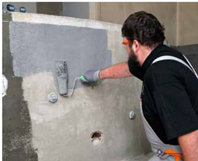
PCI Seccoral® 2K Rapid kan door rollen of spachtelen worden aangebracht. Hier wordt een contactlaag van PCI Seccoral® 2K rapid door rollen aangebracht.
