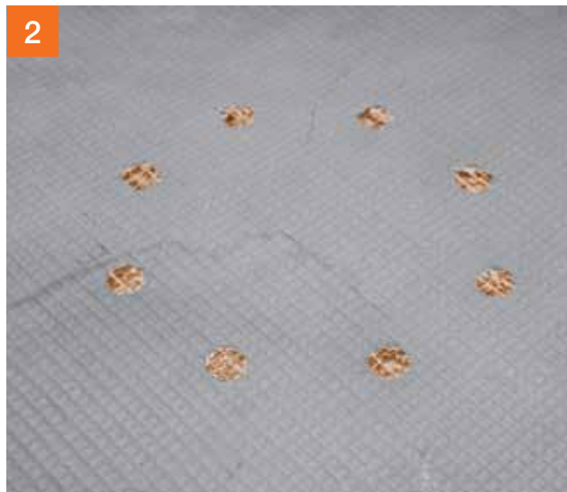
2 Knowhow: Om de combinatie van dichtring-manchet/dichtring-flens-schroeven eenvoudig en snel te kunnen samenstellen, moet een sjabloon worden gemaakt overeenkomstig de boorgaten in de klemflens.
