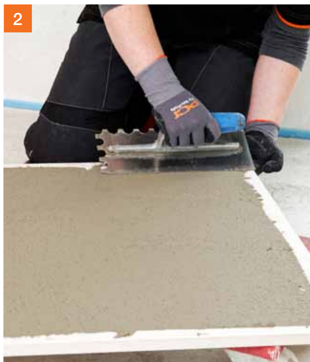
2 Aanbrengen van een contactlaag op de achterzijde van het natuursteen om er zeker van te zijn dat holte vrij wordt gelijkend
