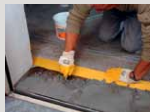
Egaliseren van een drempel of traprede met niet vloeiende epoxy-mortel PCI Aposan®.
