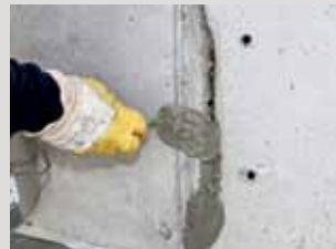
Scheuren en spleten zorgvuldig sluiten met mortel (eventueel van tevoren groter maken).
