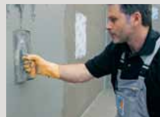
Aanbrengen van de snelbindende, scheuroverbruggende, UV-bestendige afdichting PCI Seccoral® 2K Rapid in een waterreservoir.
