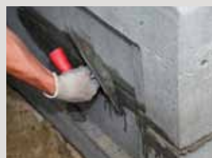
Afsluiten van voegen en herstellen van hoeken en randen met PCI Nanocret® R2.
