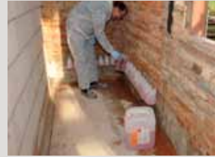
Aanbrengen van PCI Bohrlochsperrre als dampremmende laag in metselwerk tegen optrekkend vocht.
